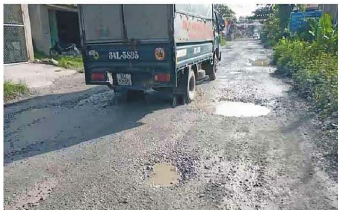
Tuyến đường xuất hiện đầy ổ gà, ổ voi
