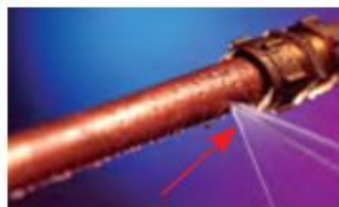
Leak 누설 Rò rỉ
