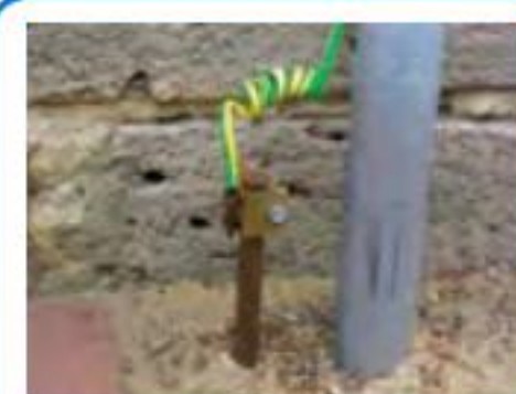
Ground connection 접지 Tiếp địa
