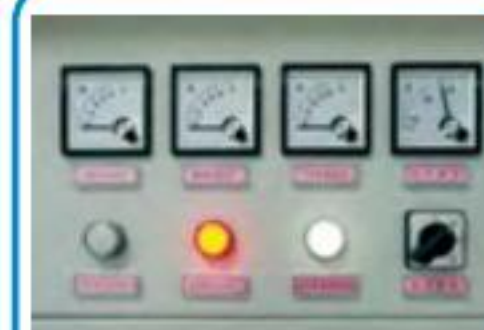
Panel board 배전반 Bảng điện
