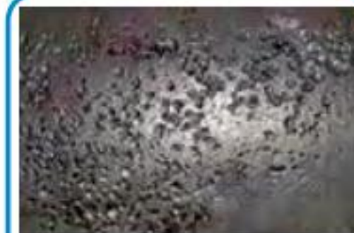
Pit 피트 Lỗ rỗ trên bề mặt kim loại
