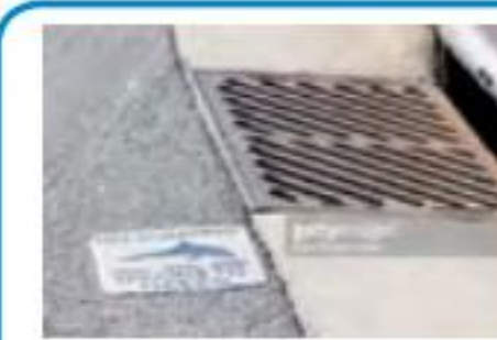
Drain 배수 Cống thoát nước
