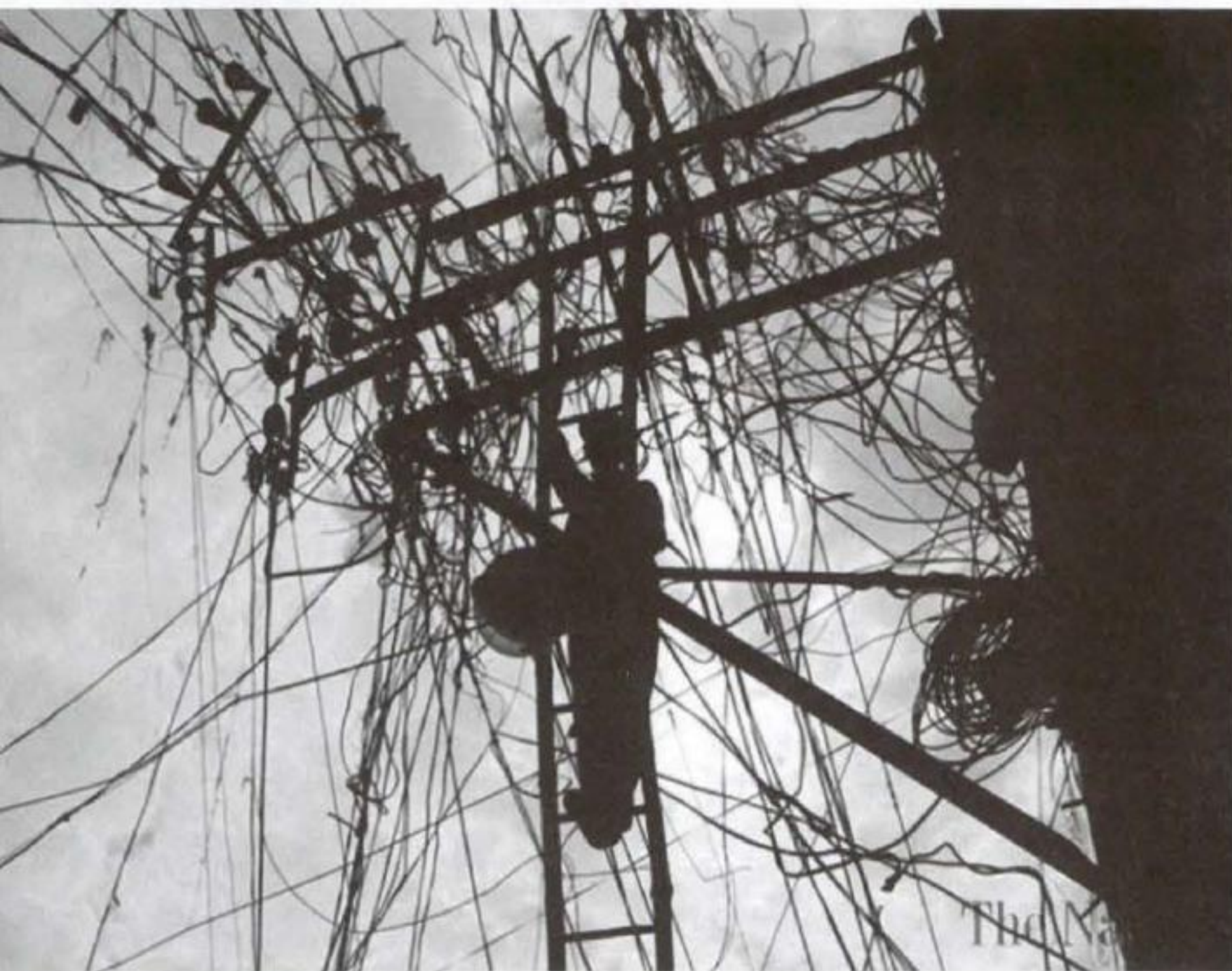
Câu móc trên lưới điện hạ áp là hành vi ăn cắp điện phổ biến
