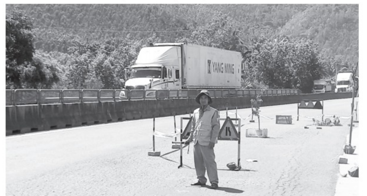
Lắp đặt cảnh báo tại khu vực xuất hiện "hố tử thần" trên QL1, đoạn qua Phú Yên
