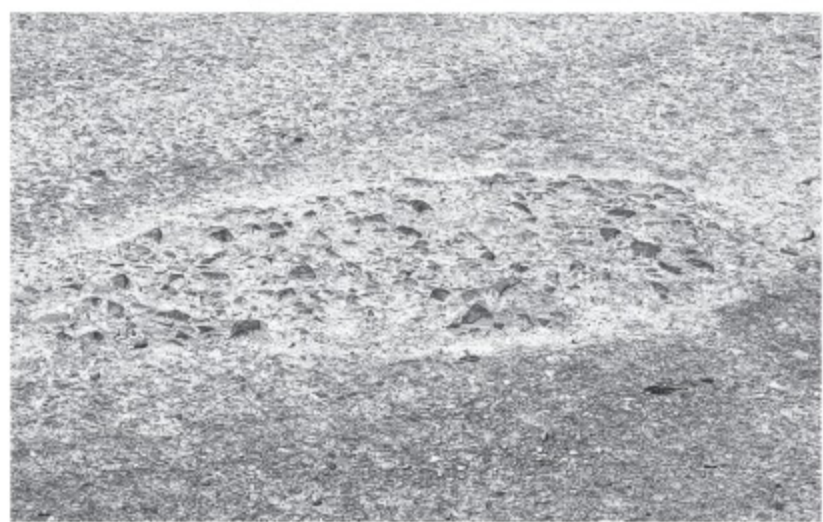
Việc dặm và bằng nhựa nóng phun trực tiếp xuống mặt đường rồi rải đá lên khiến mặt đường bị lồi lõm
