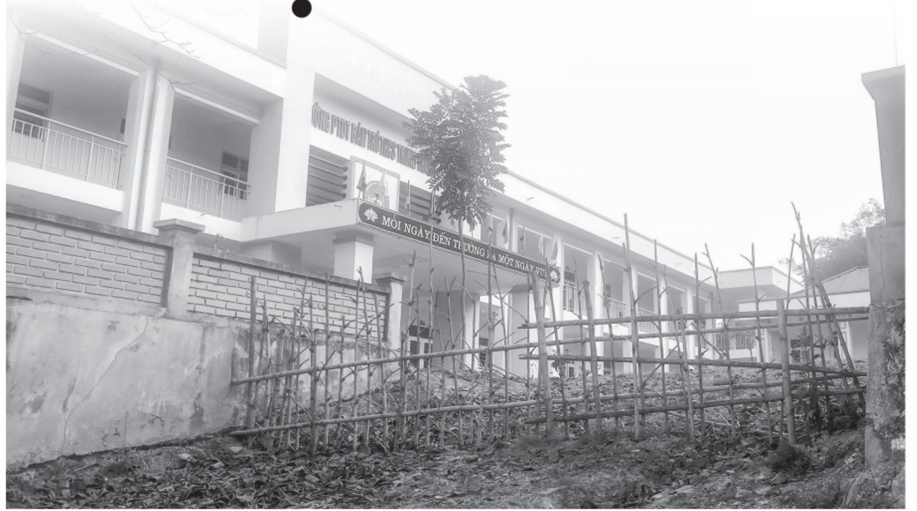
Trường PTDTBT - THCS Trung Thành dù mới được xây dựng nhưng phải đóng cửa vì sạt lở
