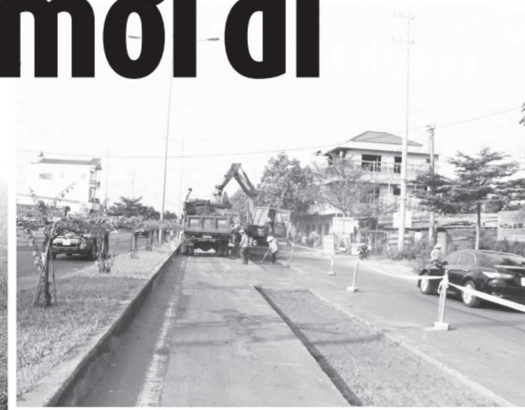
Đường tránh tây TP.Buôn Ma Thuột lắp lại “điệp khúc” hư rồi sửa, sửa rồi lại hư ẢNH: HOÀNG BÌNH
