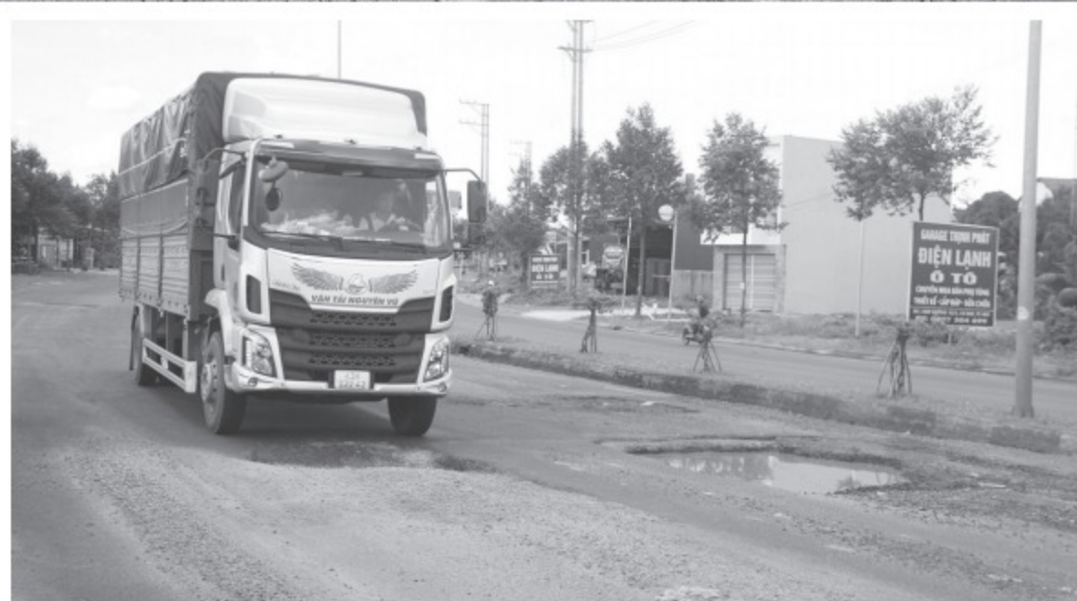
Hố sâu xuất hiện giữa đường tránh tây TP.Buôn Ma Thuột hồi tháng 11.2022 ẢNH: HOÀNG BÌNH
