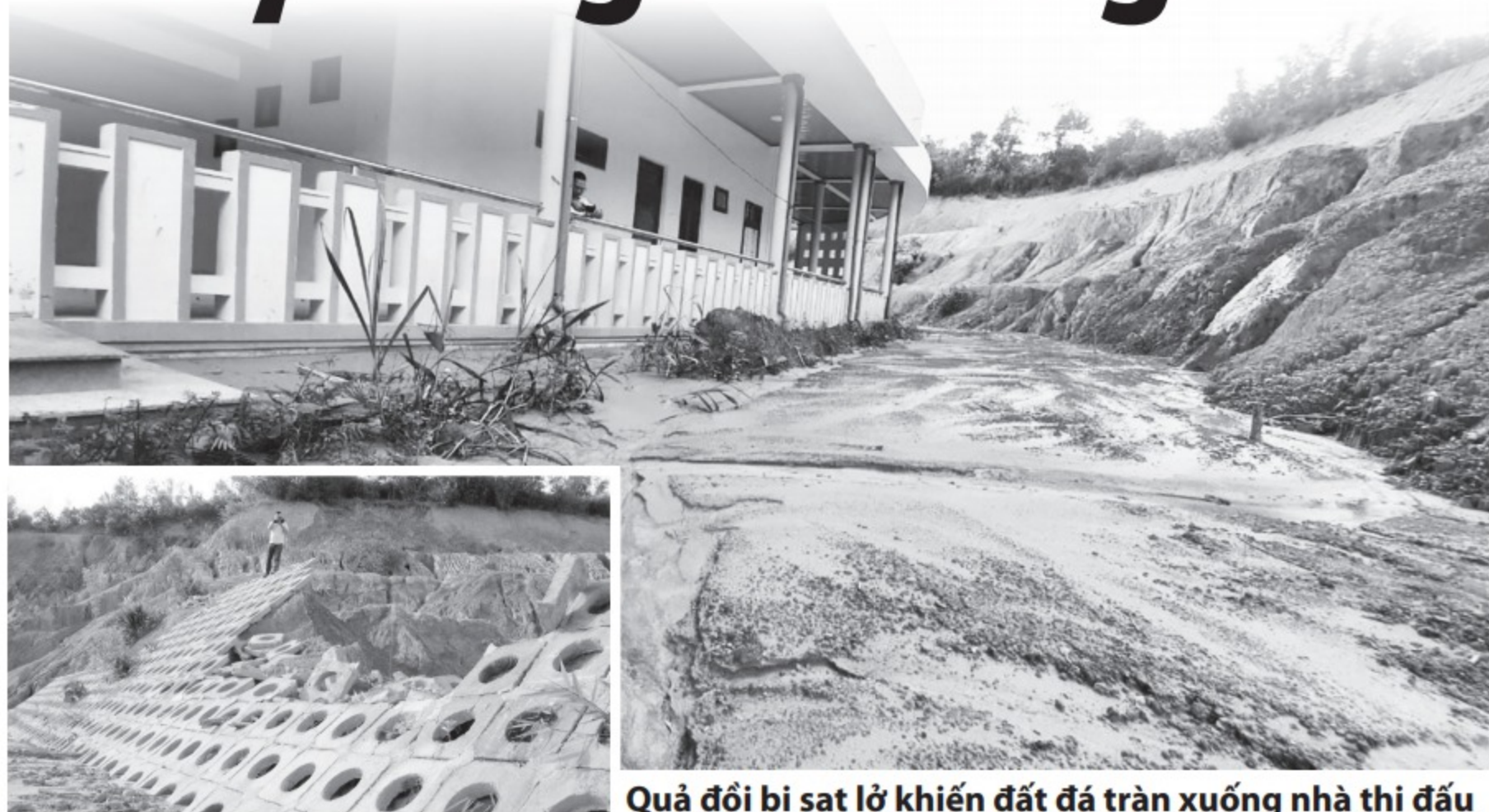
Tùng măng kè hoa sạt lở, bong tróc
