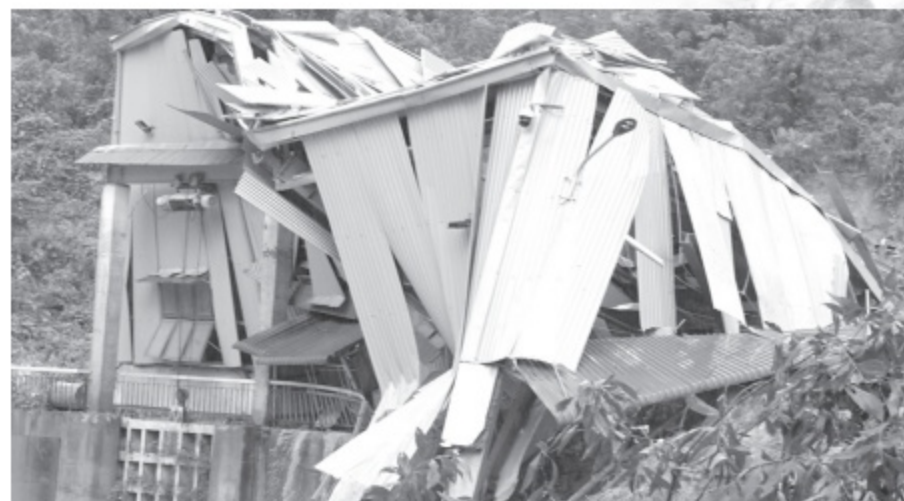
Trạm điều hành thủy điện Kà Tinh 1 (H.Trà Bồng, Quảng Ngãi) sau khi núi sạt lở
