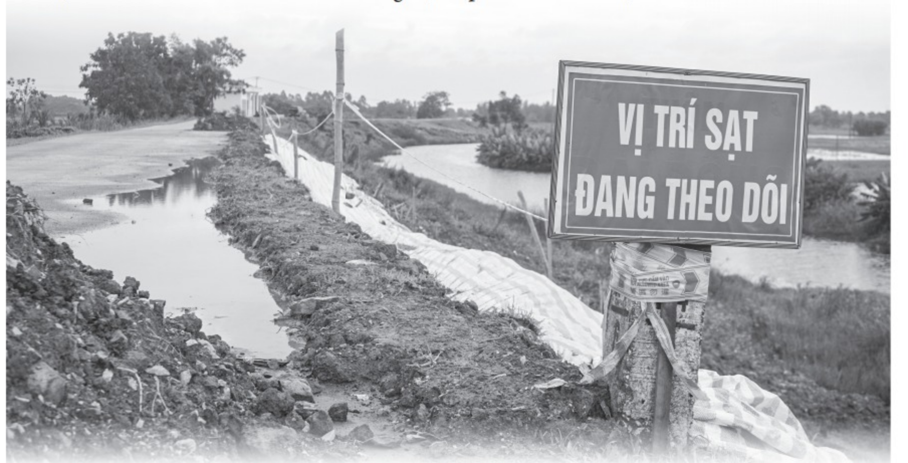
Đê tả sông Mã bị sụt lún dài 1 km, đe dọa an toàn tính mạng, tài sản của hơn 29.000 người dân
