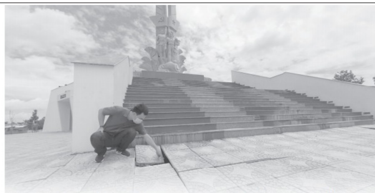
Công trình sụt lún nghiêm trọng tạo thành vồng và hố sâu ngay mặt tiền tượng đài
