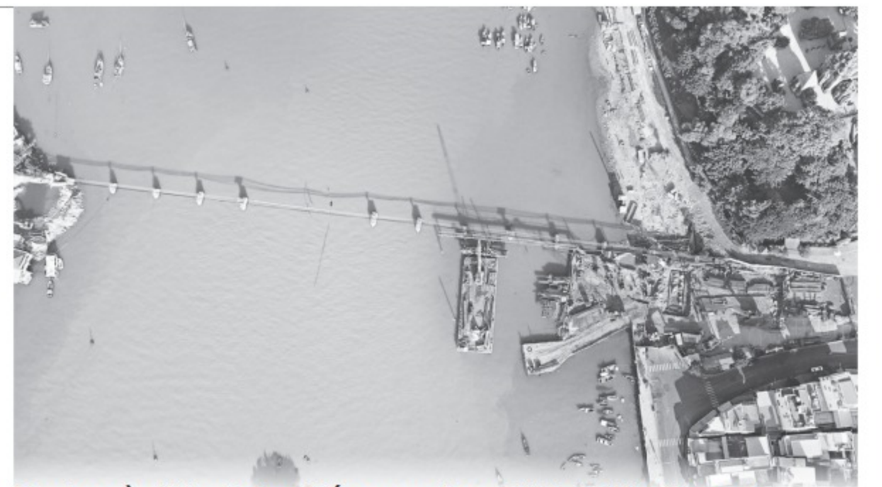
Dự án cầu Xóm Bống bắc qua sông Cái (TP.Nha Trang) có nhiều thiếu sót trong thi công
