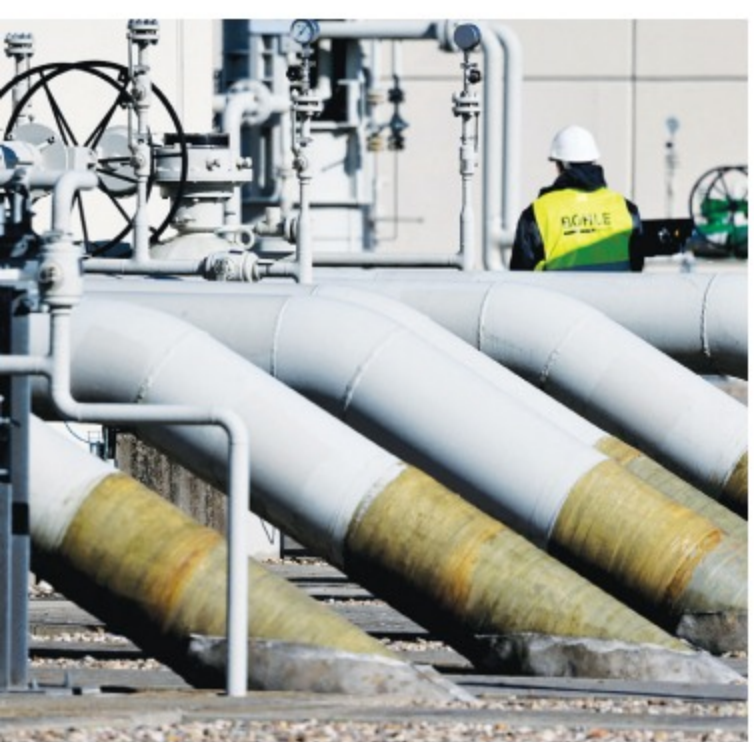
Đường ống khí đốt Nord Stream 1 tại Đức
