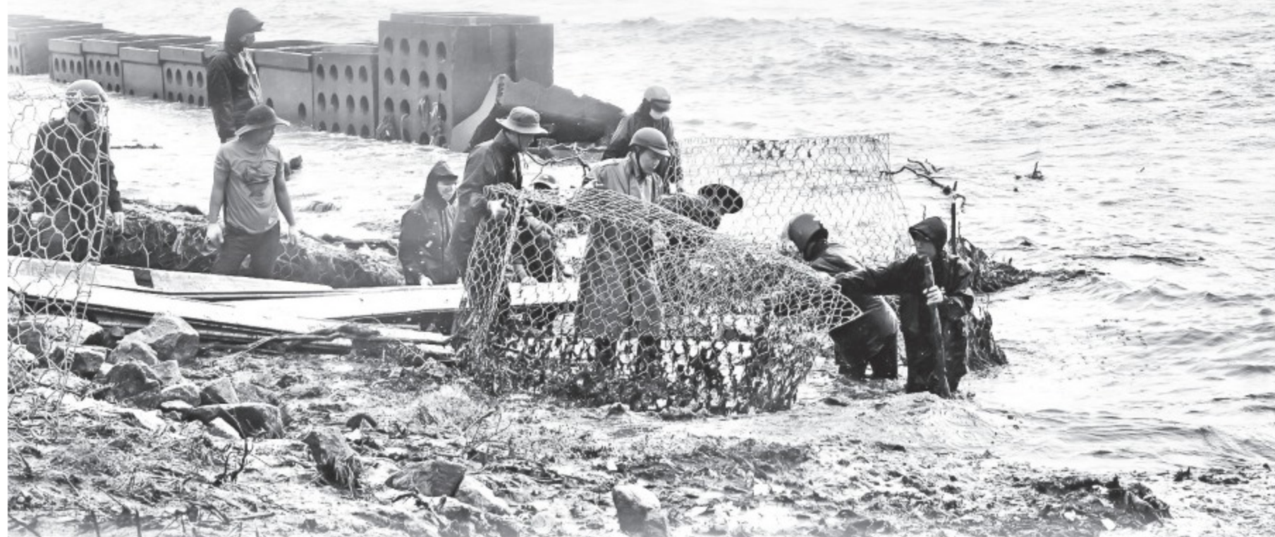
Nhiều đoạn đê biển ở Cà Mau bị sạt lở nghiêm trọng
