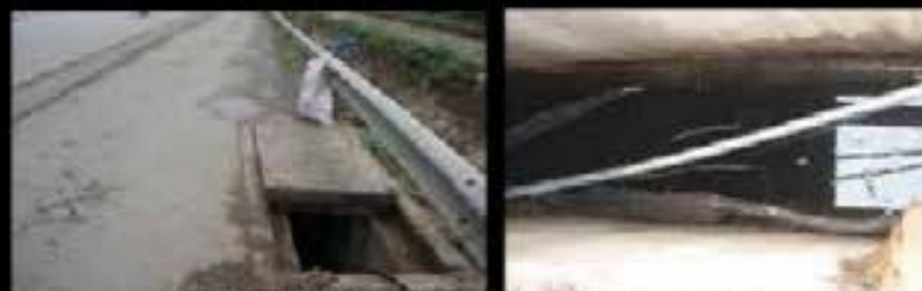
Hình 3: Hệ thống cống bê dọc theo tuyến đường Nguồn: Tác giả; PCS.TS. Trần Tuấn Hiệp
