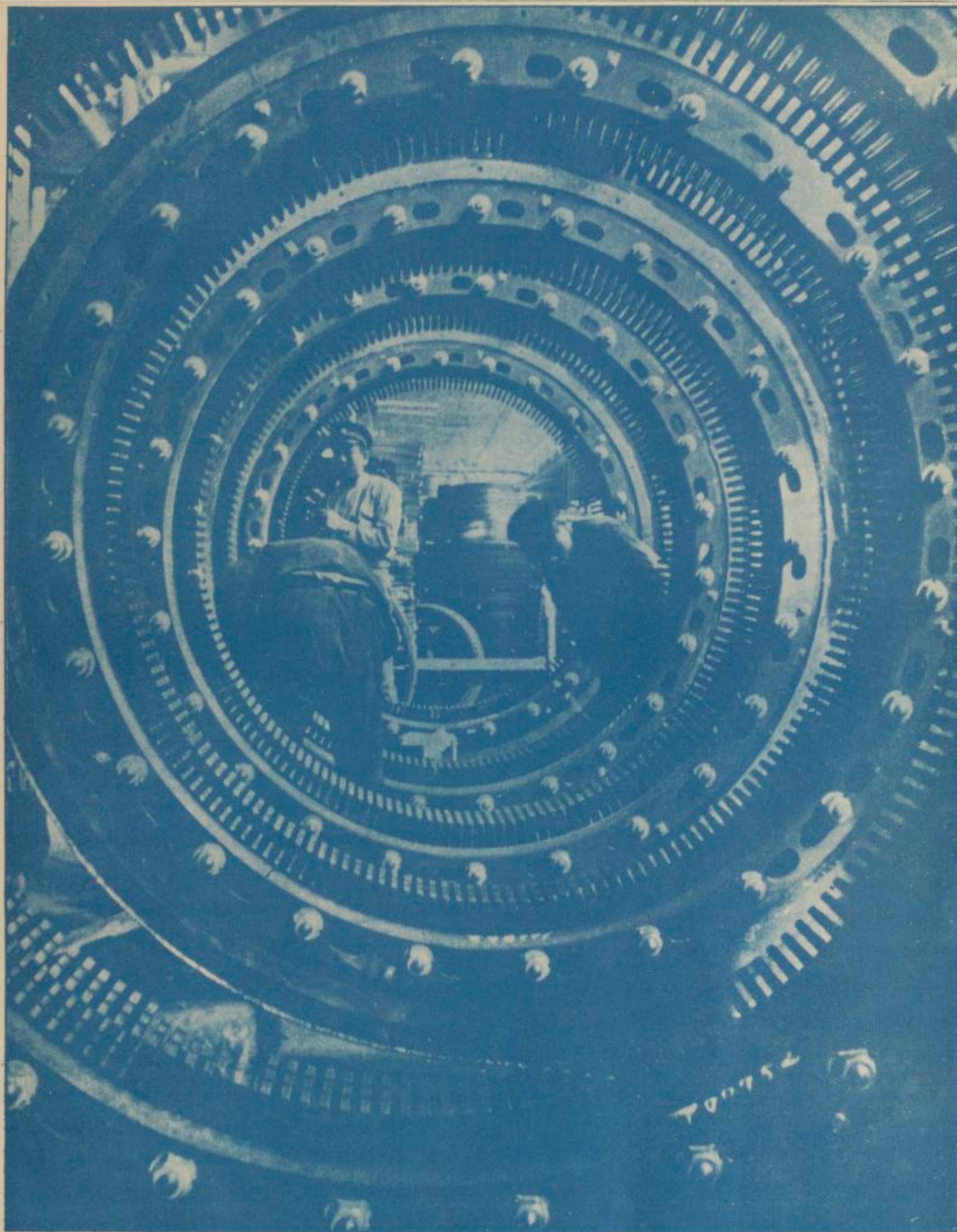
Một bộ máy trong nhà máy điện.
