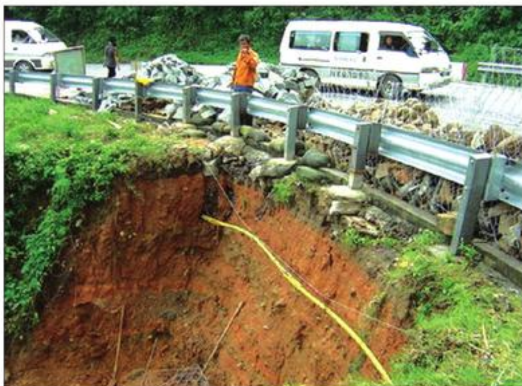
Đèo Hải Vân bị sạt lở vì nước lũ
