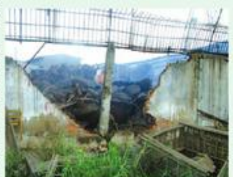
Một phần của nhà máy thép bị nổ, sụp đổ hoàn toàn.
