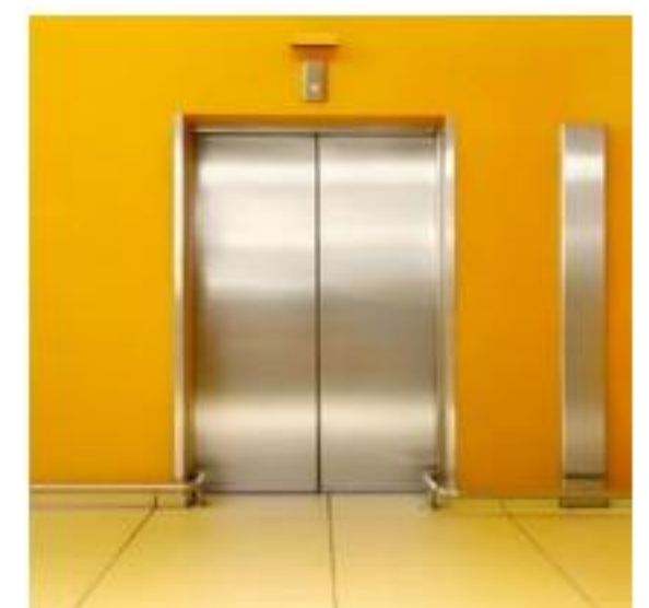
Hình 68. Cầu thang máy
