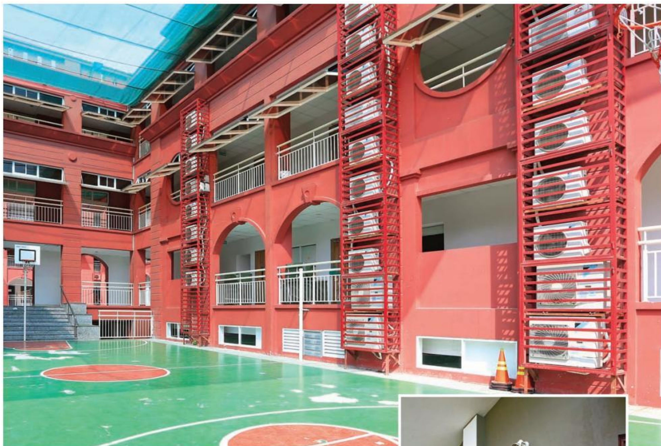
Ảnh trên và dưới Dàn nóng không nên lắp đặt ở các nơi có nguồn nhiệt, hơi nước, khói thải, hóa chất gây bẩn và ăn mòn
