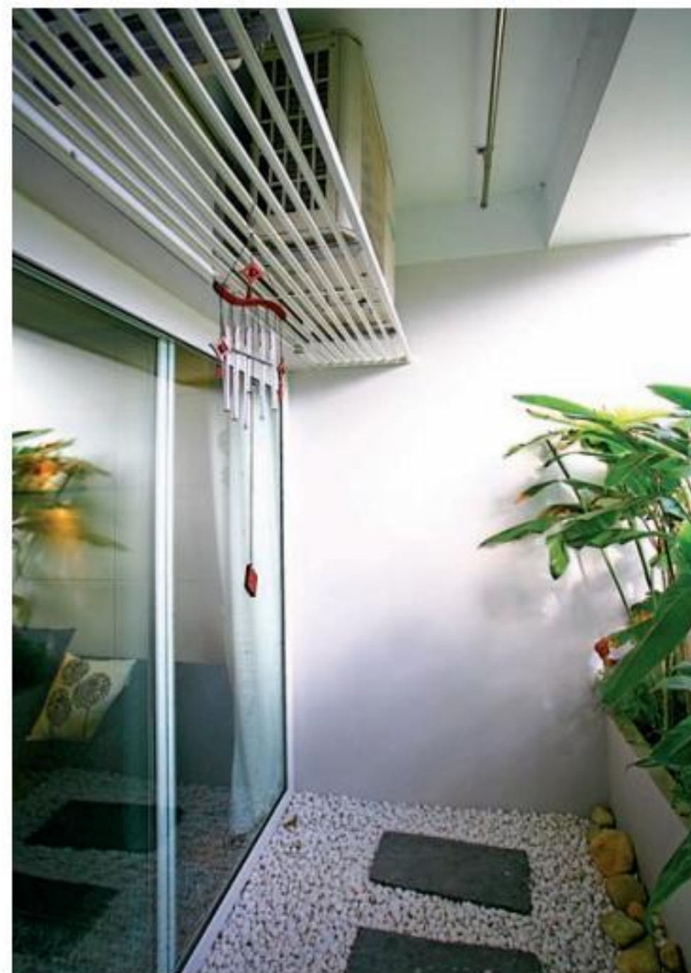
Dàn nóng đặt ở logia sẽ được bảo quản tốt hơn và tiện cho việc bảo dưỡng, sửa chữa
