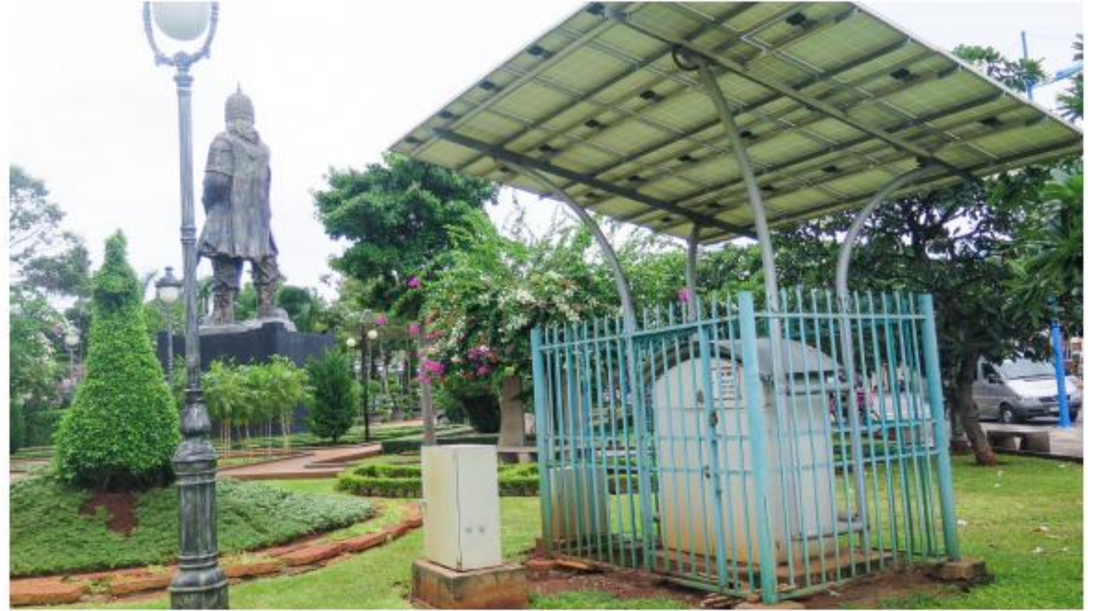
Hệ thống điện mặt trời lắp đặt tại Công viên Trần Hưng Đạo (TP. Vũng Tàu).
