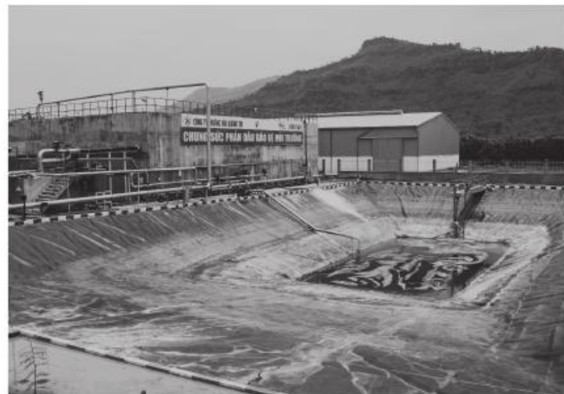
Khu xử lý nước thải tại Công ty thương mại Quảng Trị năm 2015.
