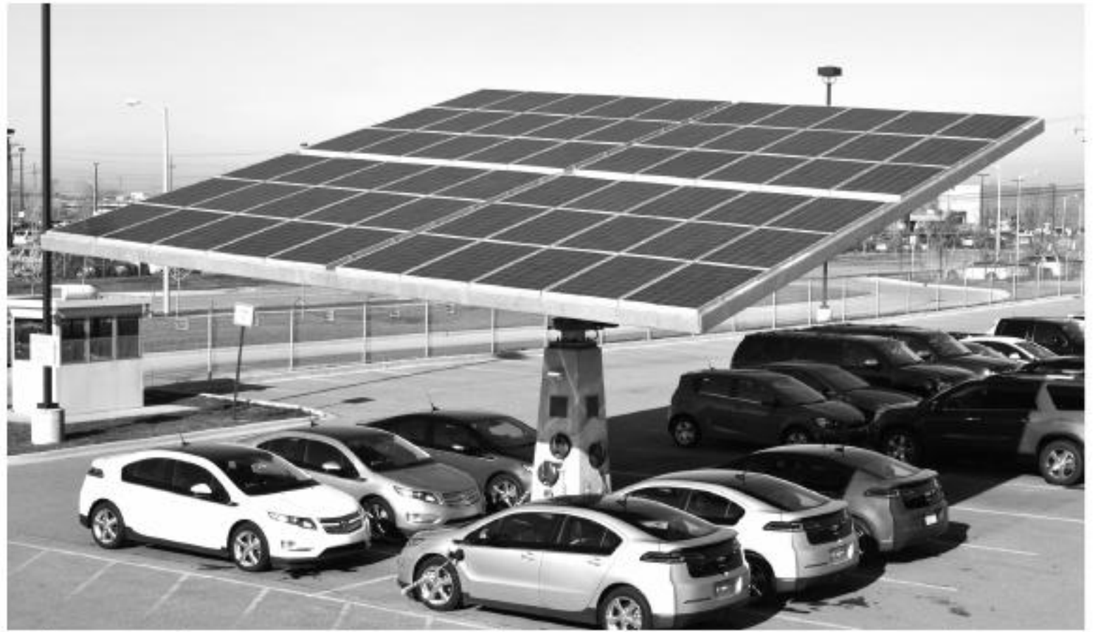
Hệ thống sạc điện cho ô tô bằng năng lượng mặt trời của Công ty Envision Solar ở California, Mỹ.
