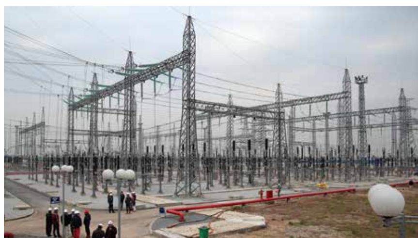
Sân phân phối 220kV Nhà máy Nhiệt điện Thái Bình 2 được đóng điện thành công. Ảnh: PVN
