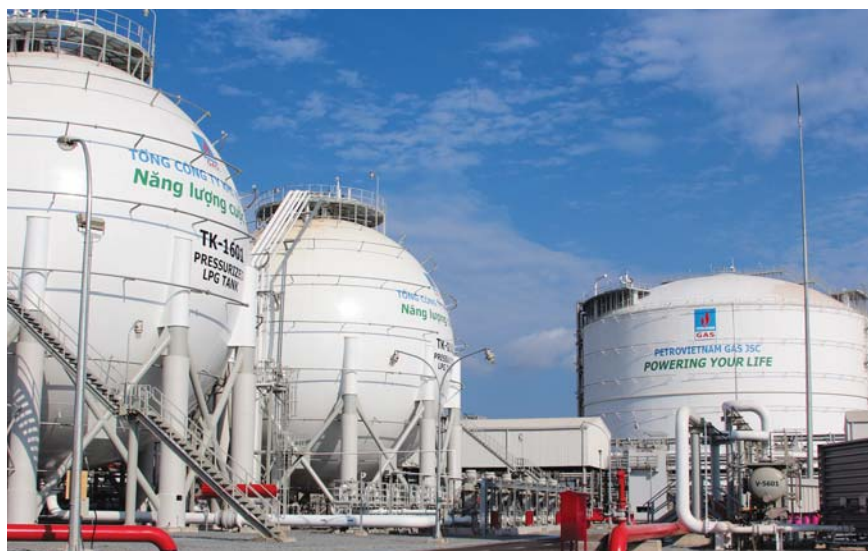
Kho LPG lạnh Thị Vải. Ảnh: PV GAS
