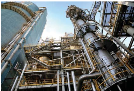
Nhà máy Đạm Phú Mỹ. Ảnh: PVFCCo
