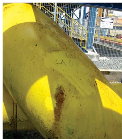
Hình 11. Đường ống dẫn khí
