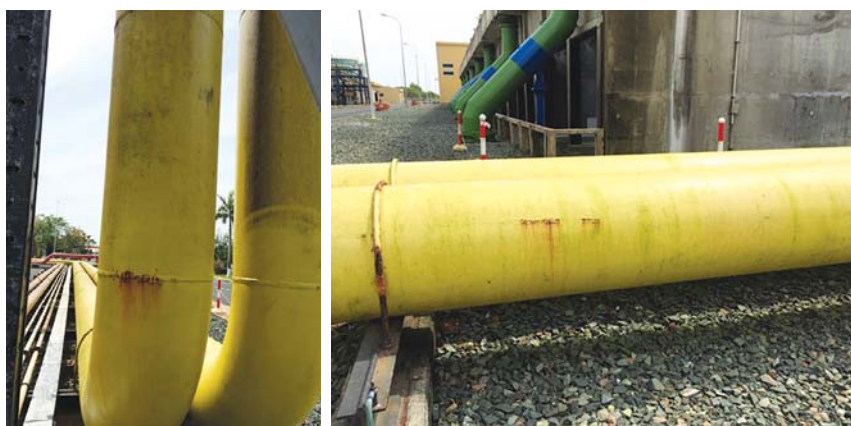
Hình 6. Đường ống dẫn khí Điện Cà Mau 1
