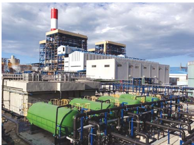
Với việc đưa thêm Nhà máy Nhiệt điện Vũng Áng 1 vào vận hành thương mại, Tập đoàn đã nâng tổng công suất phát điện hiện nay lên trên 4.200MW. Ảnh: PVN
