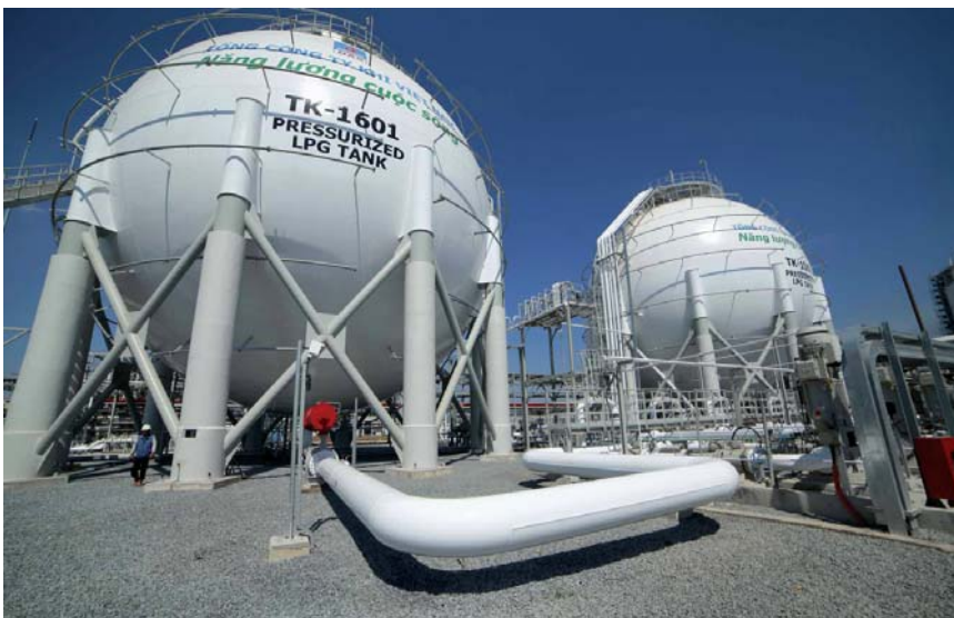
Kho LPG lạnh Thị Vải được hoàn thành và đưa vào sử dụng ngày 20/3/2013. Ảnh: CTV
