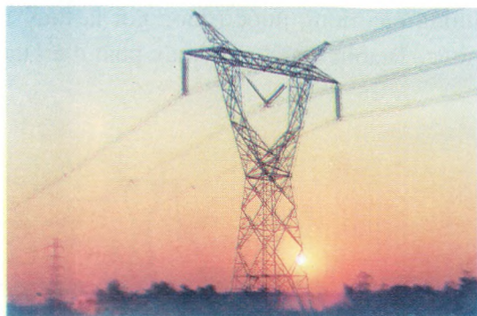
Hình 32.4. Đường dây truyền tải điện cao áp
