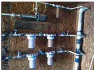
▲ Hình 3. Đường ống 4 inch từ giếng với đường nối hệ thống nước 1 inch tới núm uống nửa trước và nửa sau của trại và tới hệ thống làm mát.
