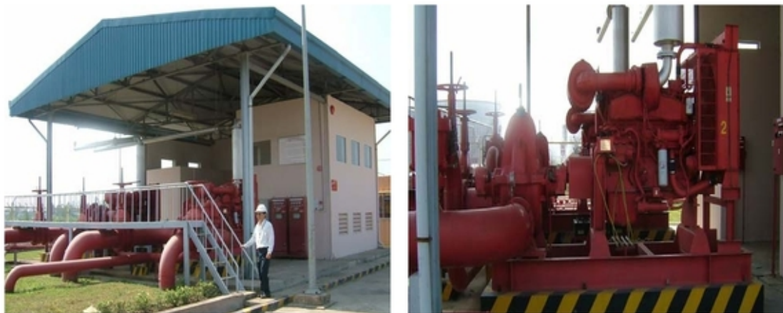
Hình 2.4. Trạm bơm cầu hoá và thiết bị phòng cháy kho GAS của Ptrolimex.
