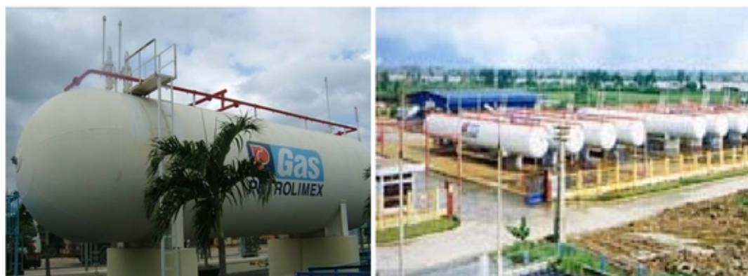
Hình 2.1. Các loại bể chứa LPG trong một kho GAS Petrolimex
