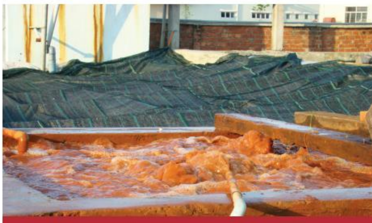
Bể xử lý nước thải công nghiệp của TP Đà Nẵng Ảnh: Hoàng Văn Chiên/PanNature
